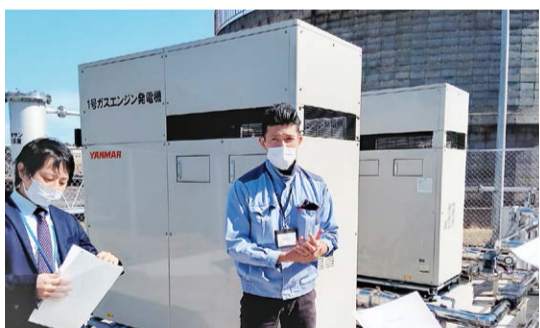
下水道消火ガスによる発電施設の説明をする米子市職員
